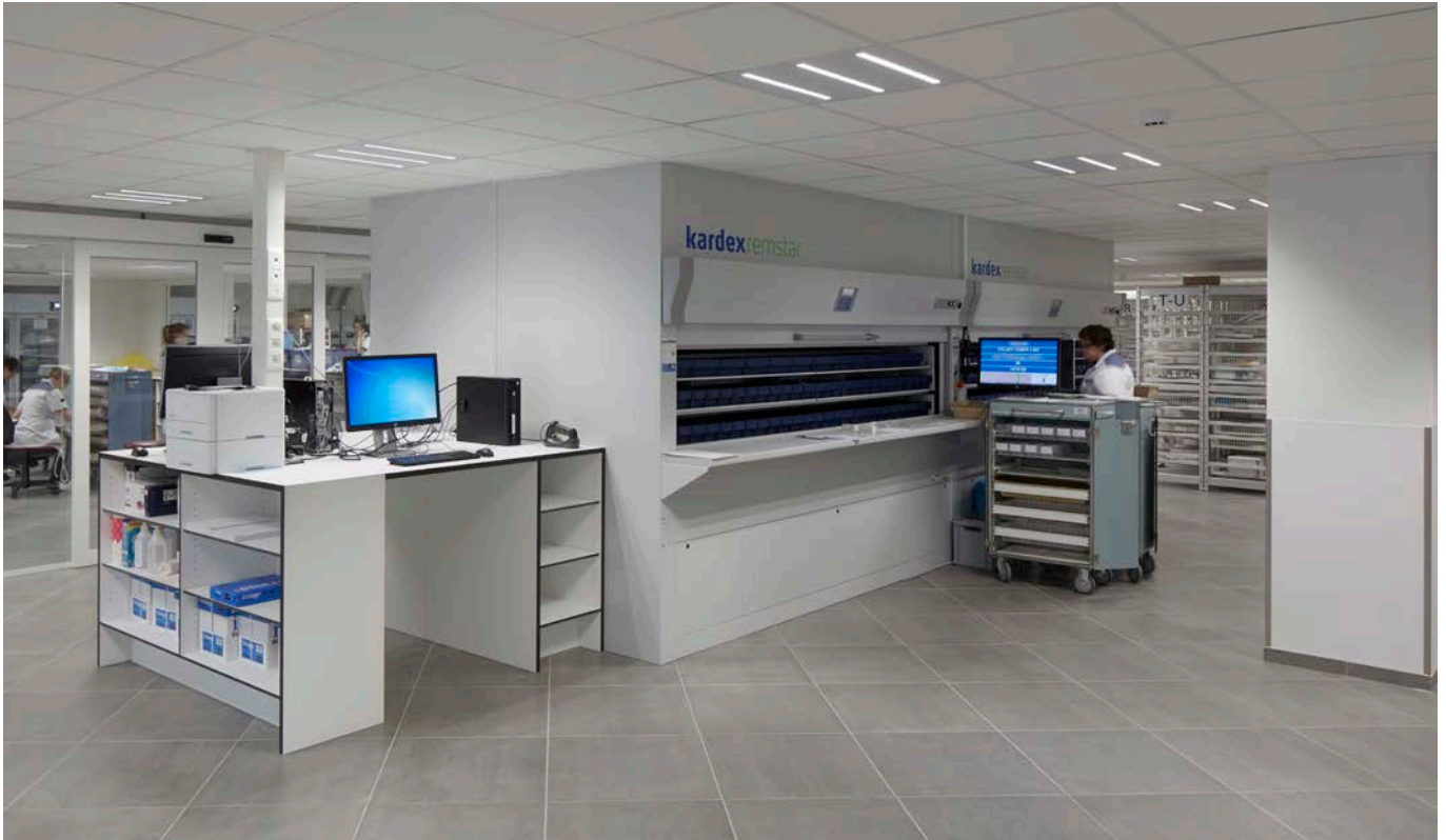
Medicatie opslag- en overslag d.m.v. Kardexkasten, medicatierobotten en rowaksten
