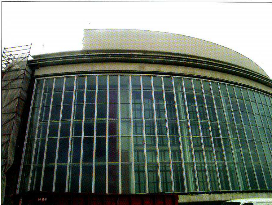
De bouwfysische staat van het gebouw was zo slecht dat zowel de gevelmaterialen als de interieurmaterialen dringend moesten worden vervangen
