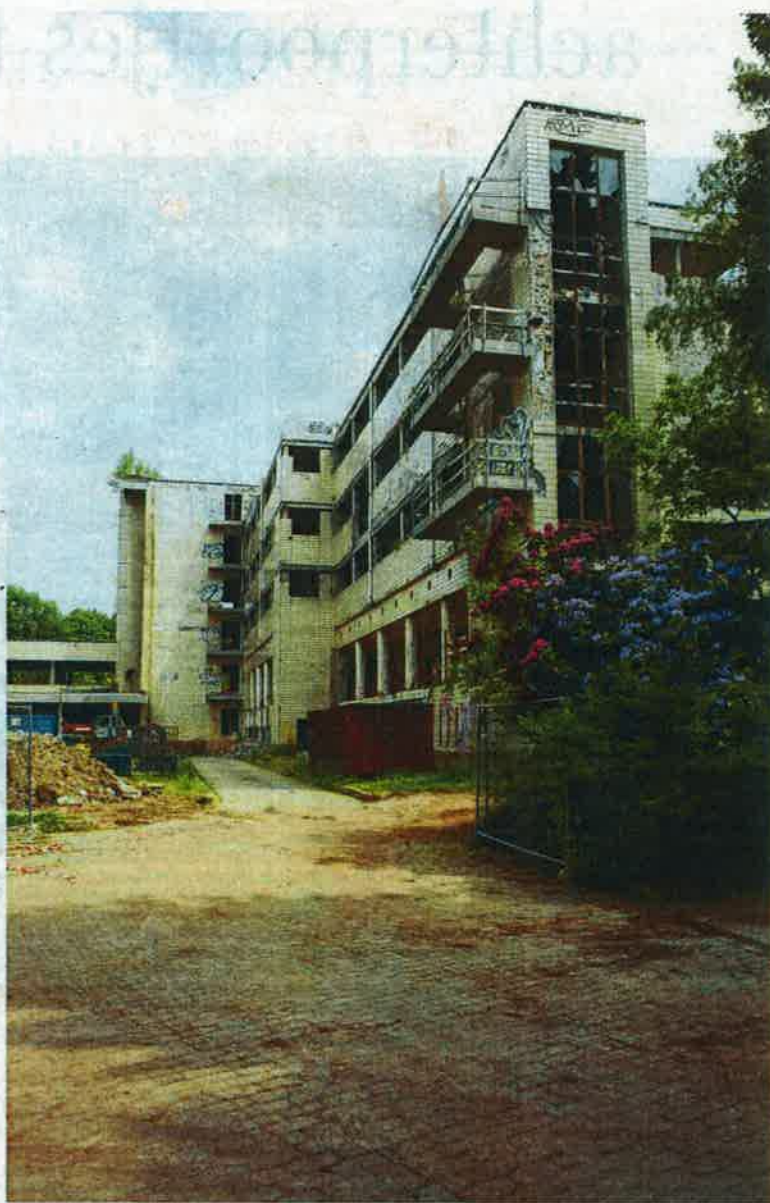
Het gebouw is in slechte staat, maar de renovatie is al volop aan de gang. © rrr
