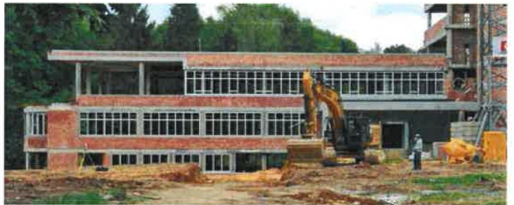
Het visuele aspect van de ramen was uiterst belangrijk. In totaal zitten er in dit sanatorium 1.700 m 2 raampartijen verdeeld over ca. 260 stuks
